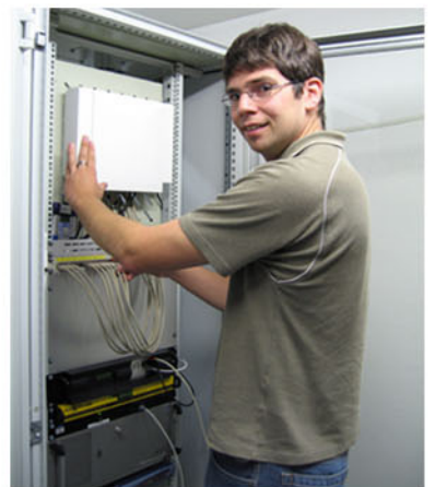
Systemingenieur Andreas Stegemeier
